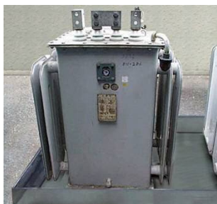
変圧器（トランス）
