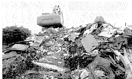
田んぼに接した敷地に土砂など解体廃棄物が不適正保管
