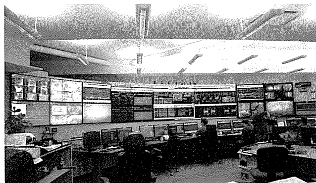
焼却施設の中央管制室
