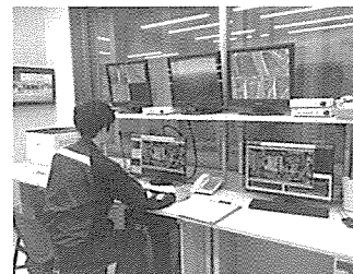
タービン発電機その他補機類を管理する中央制御室
