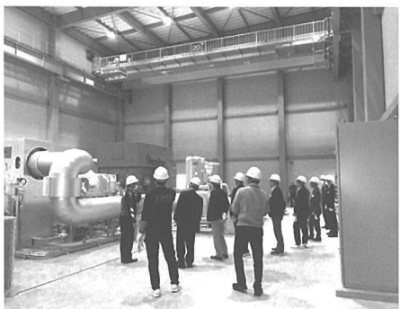
発電所内の設備機器について説明を受ける
