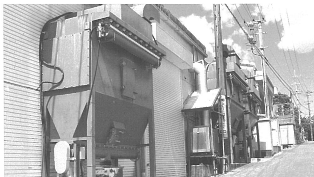
室外の集塵機
