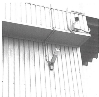
工場に設置された監視カメラ
