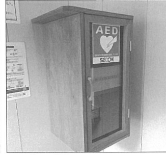
工場内に設置されたAED
