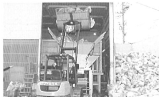
集荷された廃棄物は重機で破袋機へ投入される
