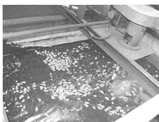
中和処理の設備
