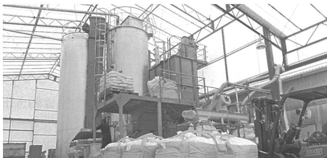
固化材製造装置
