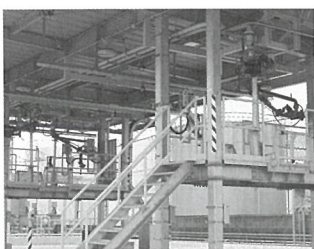
廃油処理・リサイクル施設
