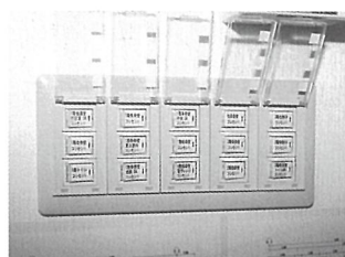
電源を一括管理する配電盤
