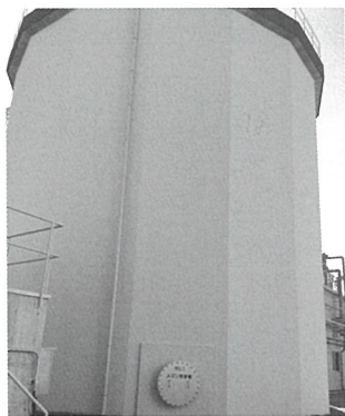
メタン発酵槽
