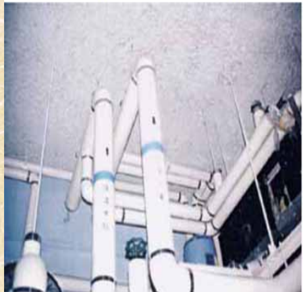
(吸音・断熱材 機械室の壁・天井)
